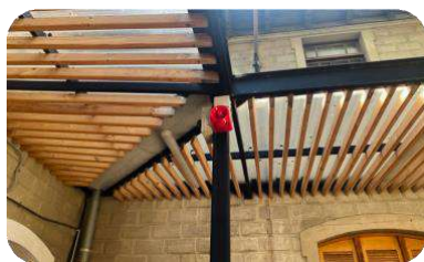
PUCV refuerza seguridad con instalación de modernas sirenas de evacuación
